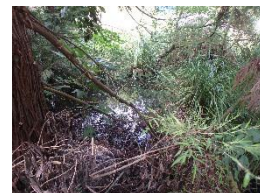
荒廃した農業用ため池
