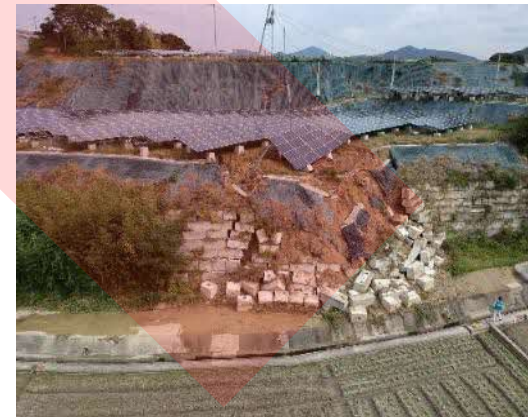
法面保護工が崩れて流出した事例
