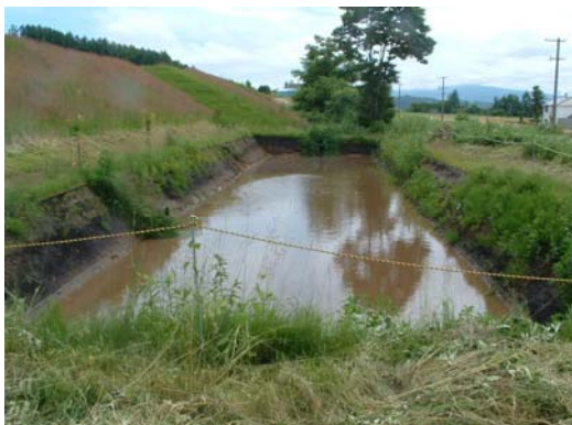
大雨後の浸透型沈砂池の土砂堆積状況
